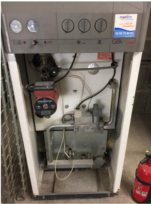
Chaudière vu face
